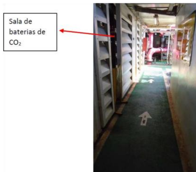
FIGURA 13 – FOTO EXTERNA DA SALA DOS CILINDROS DE CO 2 .
