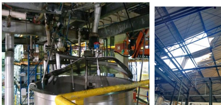
Figura 10 - Registro do incidente devido reação de hipoclorito de sódio com ácido dentro do tanque
