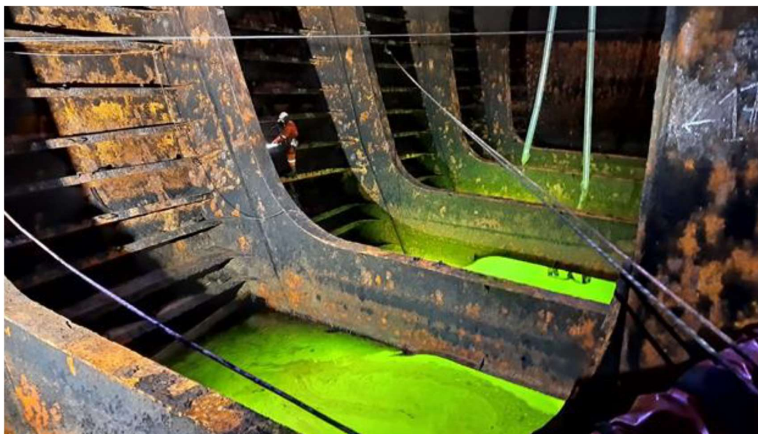
Figura 10 –Fundo do casco da FPSO Cidade do Rio de Janeiro após queda da chapa.
