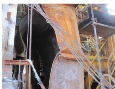
Tanque de Etanol após o rompimento
