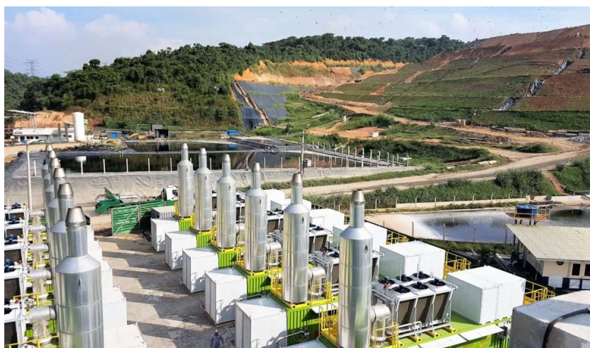
FIGURA 2.5 – USINA DE GERAÇÃO DE ENERGIA ATRAVÉS DO BIOGÁS DE ATERRO SANITÁRIO.
