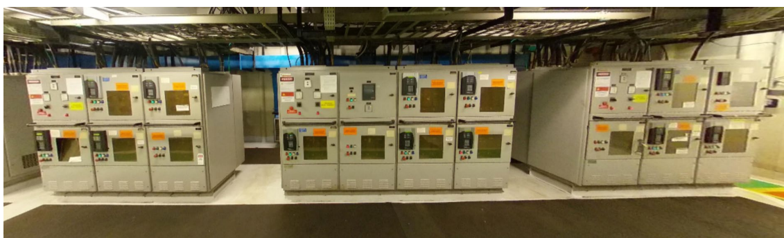
Figura 9 – Detalhe painel de distribuição ou alimentação elétrica de cargas essenciais e motóricas.
