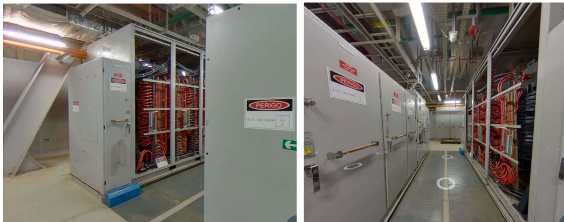
Figura 7 – Detalhe cubículo transformador de potência - sala de conversores.
