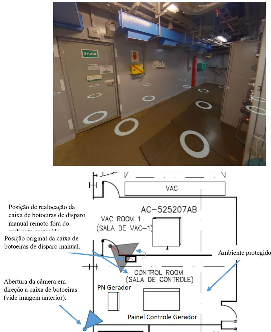
Figura 5 – Caixa de botoeiras de disparo remoto manual posicionadas incorretamente.
