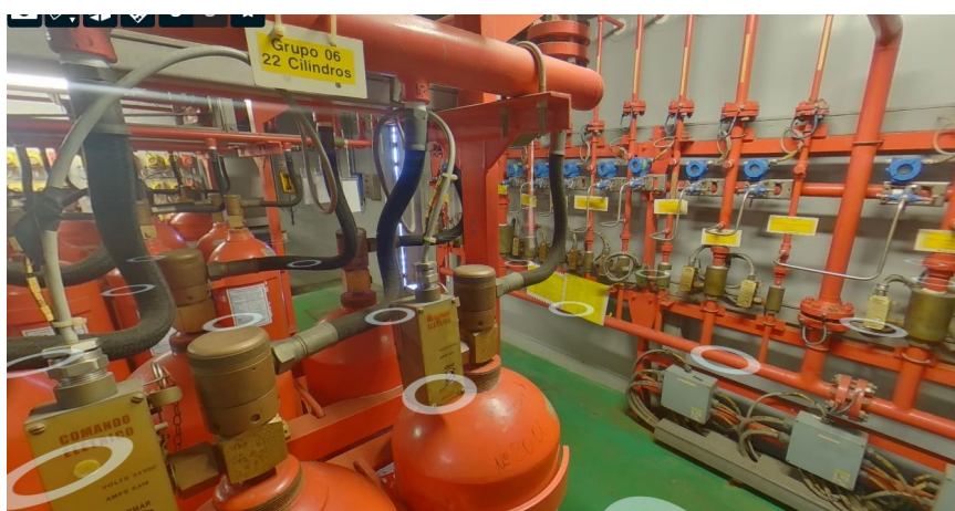
Figura 4 – Detalhe Sala de Cilindros Principal, bateria de cilindros piloto e secundário, válvulas direcionais, cabeças de comando elétrico etc.
